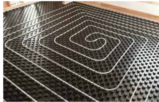
地面采暖管道系统
